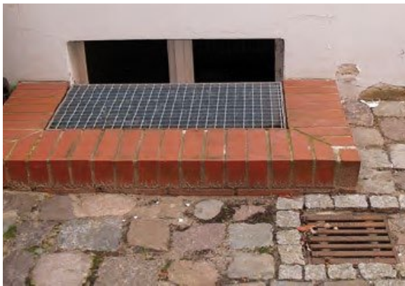
Aufkantung vor Kellerfenster Quelle: SUBV - Bremen
