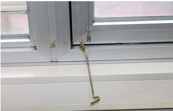
4.1 Provisorium an Bestandsfenster wegen nicht mehr verfügbaren Ersatzteilen
