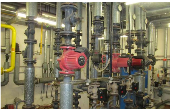
4.2 Veraltete gebäudetechnische Anlage
